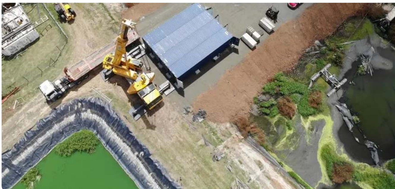
Installation complète de Reut sur la distillerie du Simon en Martinique capable de traiter 40 m 3 d'effluents par heure - Nereus
