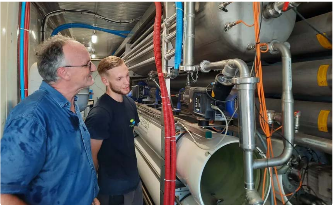
Emmanuel Trouvé et Thomas, technicien chez Nereus inspectent l'unité de filtration installée sur un camping de Vias © Radio France - Annabelle Grelier
